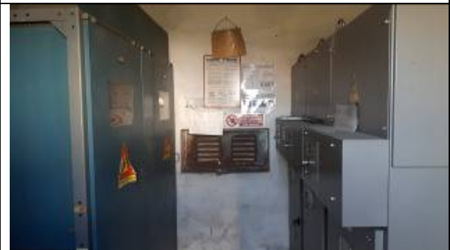
Immagine 23 Vista interno cabina elettrica lato in esercizio
