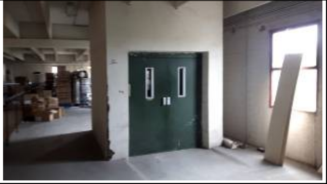
Immagine 12 Particolare ascensore
