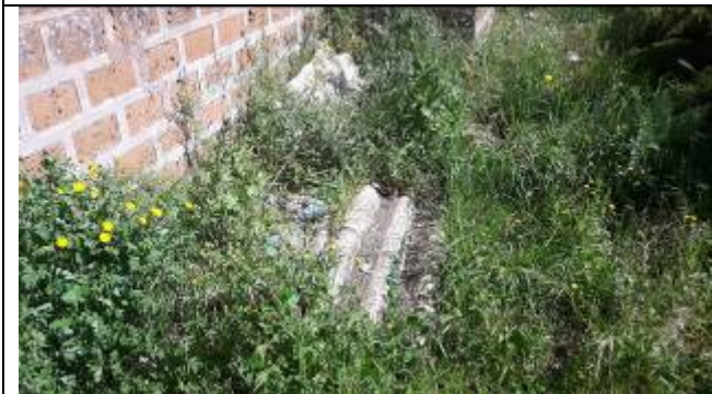
Immagine 23 Vista materiale abbandonato (anche lastre di amianto)
