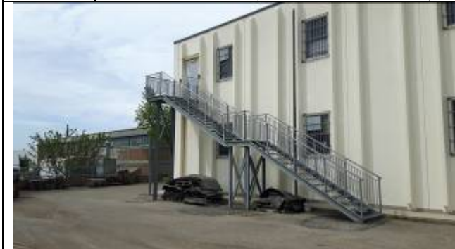
Immagine 03 Particolare scala esterna metallica da regolarizzare
